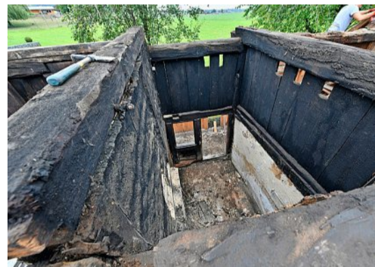
Das uralte Gebälk über der Küche hat sich im Laufe der Jahrhunderte verfärbt.
